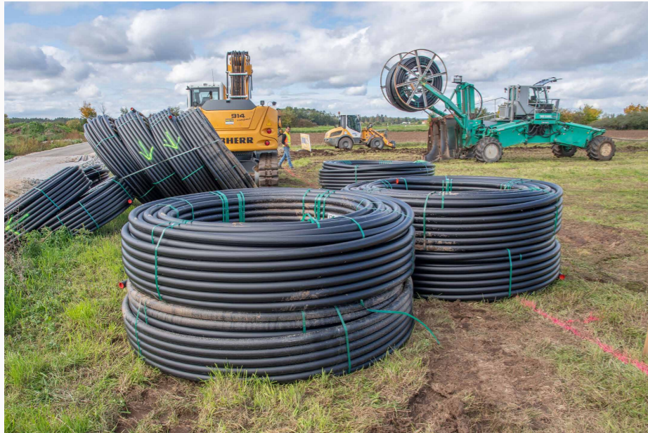
16 Kilometer Rohrleitungen werden in 2 m Tiefe durch den Leitungspflug eingepflügt. Bildquelle: Axel Rieger, wbg Nürnberg
