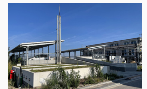
Blockheizkraftwerk mit Holzpellets im Neubaugebiet RieterBogen. Foto: Martin Braun, wbg
